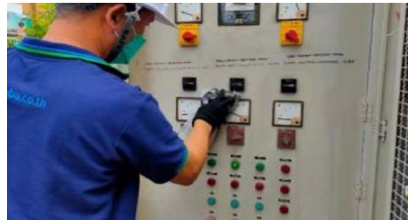
การตรวจสอบการทำงานของระบบไฟฟ้า
