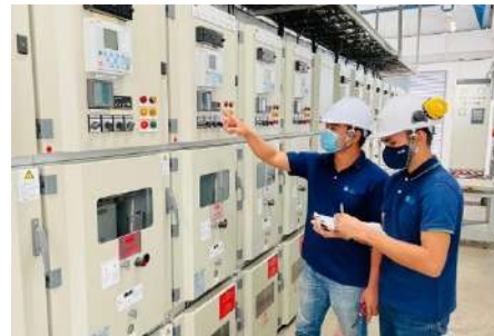
การตรวจสอบตั้งค่างานระบบไฟฟ้า
