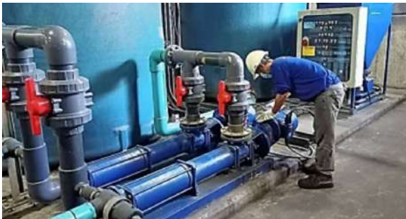
การตรวจสอบการทำงานตามแผนงานการบำรุงรักษาเชิงป้องกัน (Preventive Maintenance)
